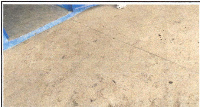
Foto 4: El corredor del aula 2, se evidencia las malas condiciones
