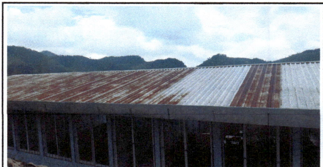
Foto 6: se evidencia la necesidad de la aplicación de pintura anticorrosiva
