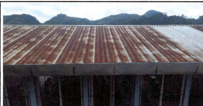
Foto 5: Se observa las condiciones de las laminas troqueladas. La necesidad de lijado
