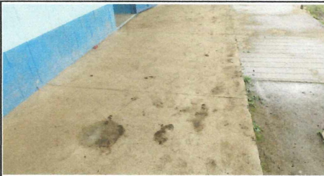
FOTO3: El corredor del INEB es necesario la sustitución de entortado por ceramico
